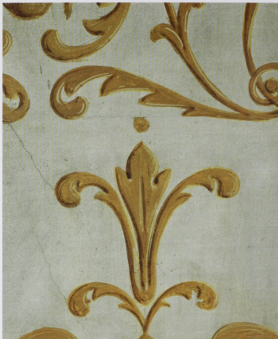
FIG. 5. Thorvaldsens Museum, rum 39. Øverst i billedet ses en del af det urensede loft, og skråt ned over loftsfladen ses en sætningsrevne. (1996).
