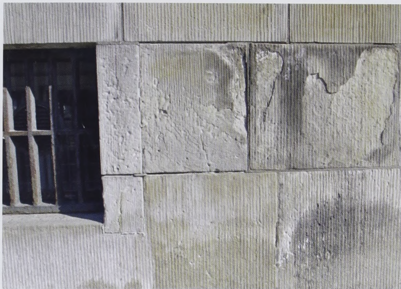
Ill. 9. Sort forureningsskorpe, salte og salteroderet område på sandstenskvadre i soklen under kanalfacaden. (Foto: BK ApS)
