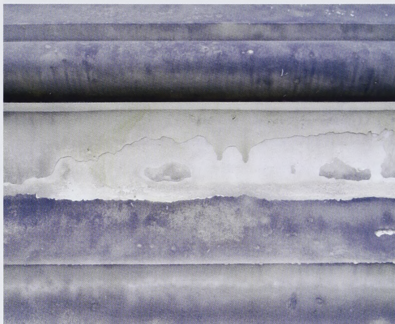
Ill. 3. Sort forureningsskorpe og salteroderet område på sandstensbase på forhallens facade mod Christiansborgs Slot. (Foto: BK ApS)
