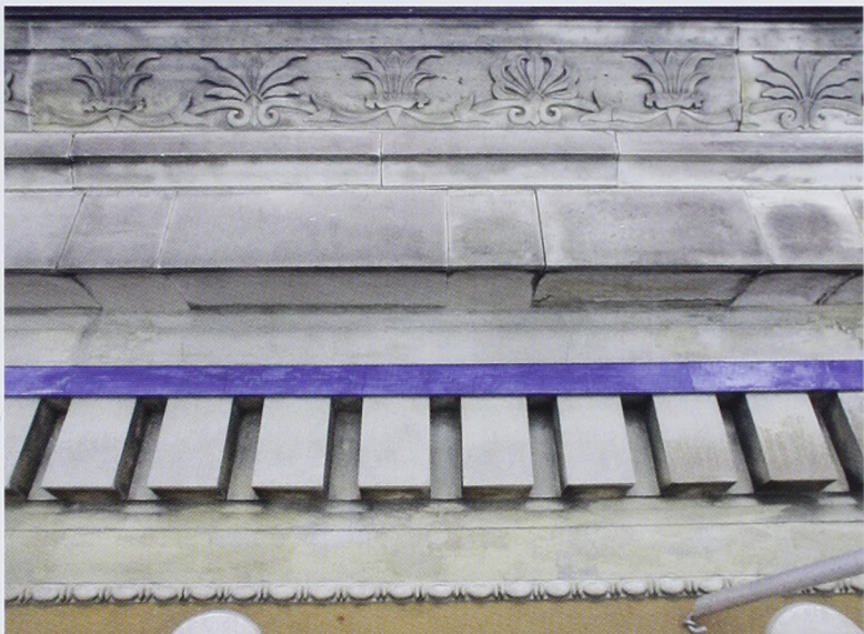
Ill. 4. Sandstensgesims på hovedfacaden før restaureringen i 2006. (Foto: BK ApS)
