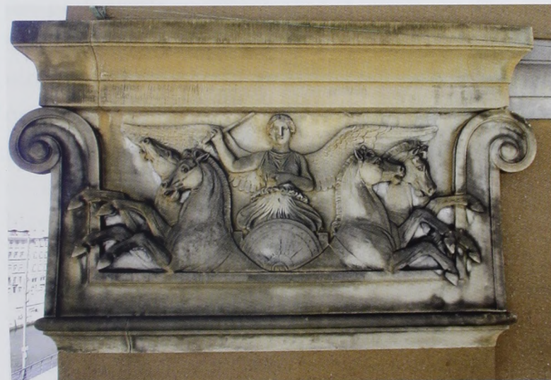
Ill. 5. Kapitælrelief på hovedfacaden før restaureringen i 2006. Udvaskning af gult pigment fra den overliggende facadepuds har farvet relieffet gult.
