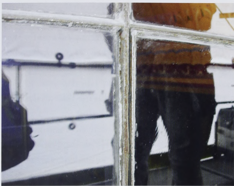
Vinduer på nordfacaden efter afrensning.
