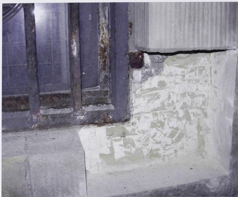
Indmuret jernbeslag blottet på nordfacade.
