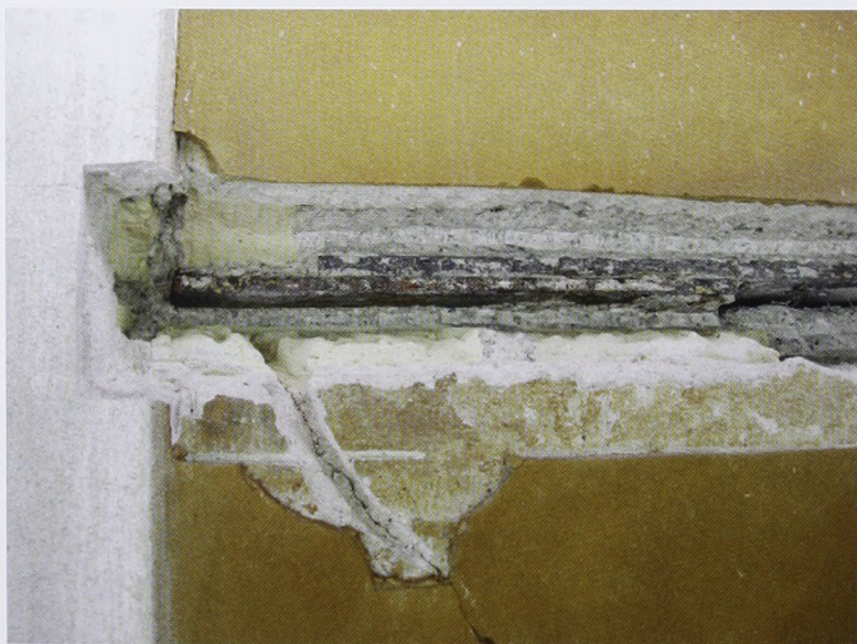
Blotlagt jernprofil på nordfacade.
